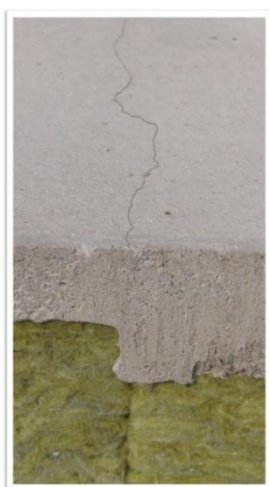
Figur 4.3.8 Spricka i oarmerad puts orsakad av geometriförändring
