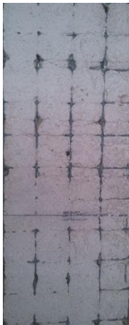
Figur 4.4.10 Exempel på "kanalsystem" orsakad av att putsbruket inte omsluter armeringsnätet.
