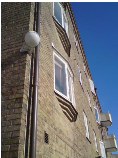
Figur 3.3.2. Byggnaden före renovering, de ursprungliga fönstren var i ett dåligt energimässigt skick och byttes ut under renoveringen (Foto av Carl-Magnus Capener, SP).
