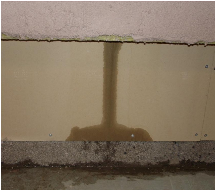
Foto 4.4.3 Vattenflöde direkt under den vertikala skarven mellan mineralullsskivorna.
